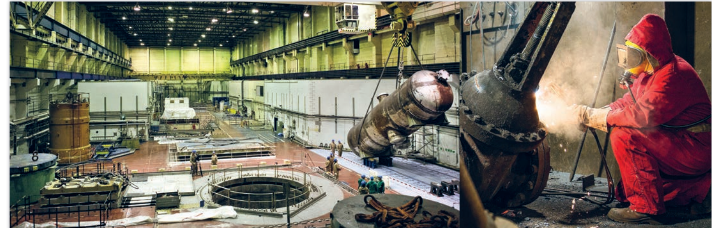
Dekontaminierungsarbeiten in der Reaktorhalle von Greifswald. Rechts im Bild ein Dampferzeuger. Bevor er ins Zwischenlager kommt, wird er zersägt.
