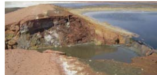
Dammbruch des Uranschlamm-Beckens Foto: www.greenpeace.org
